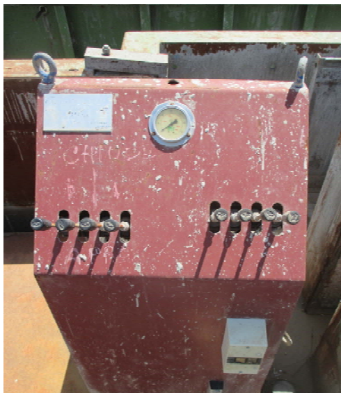
Centralina oleodinamica (unica a comando dei due casseri da 26 metri)
